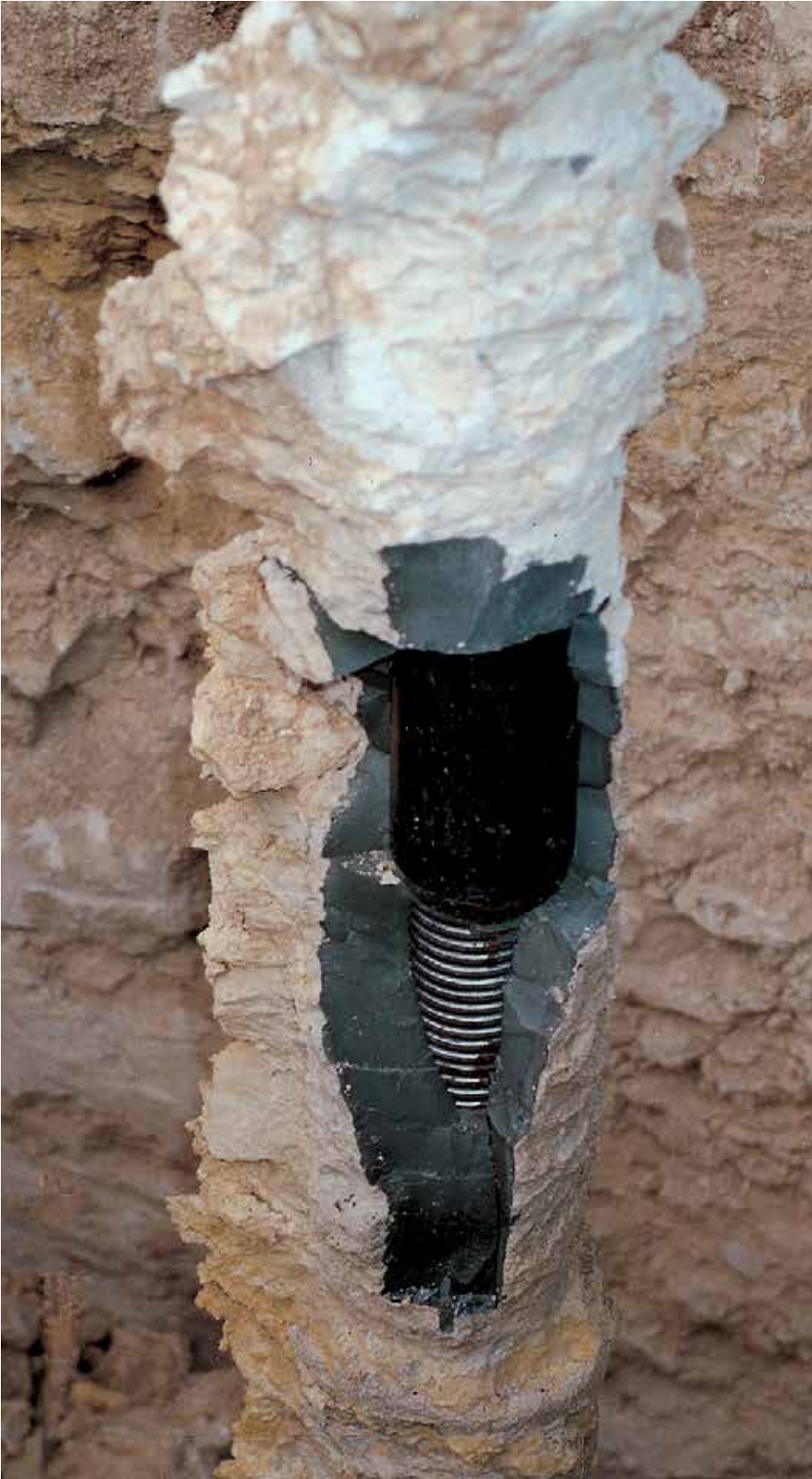
Verzahnung von Stahltragglied, Zementstein-Überdeckung, Filterkuchen und Boden. Der zur Untersuchung aufgebrochene Verpresskörper zeigt das eingeschlossene Stahltragglied mit Kopplungsmuffe – dauerhaft korrosionsgeschützt.
